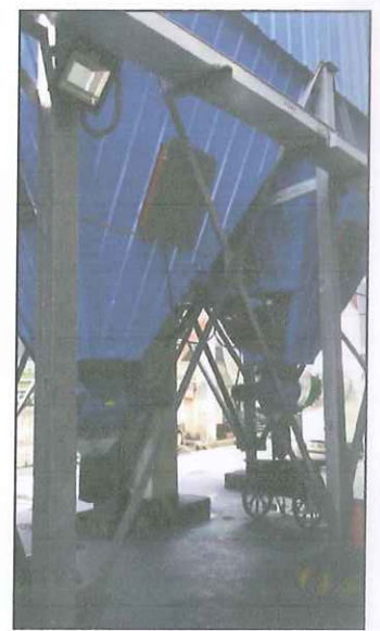
废气处理后采样口
